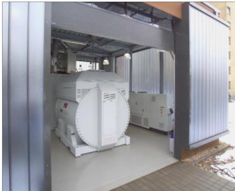
Bild 1. Im Nahwärmenetz Krefeld-Fischeln bedient das HotModule den Grundlastbedarf. Die von RWE Fuel Cells gelieferte Hochtemperatur-Brennstoffzelle stellt genügend Wärme bereit, um im Winter 40 Wohnungen zu heizen oder um den ganzjährigen Warmwasserbedarf von rd. 300 Wohneinheiten zu decken.
