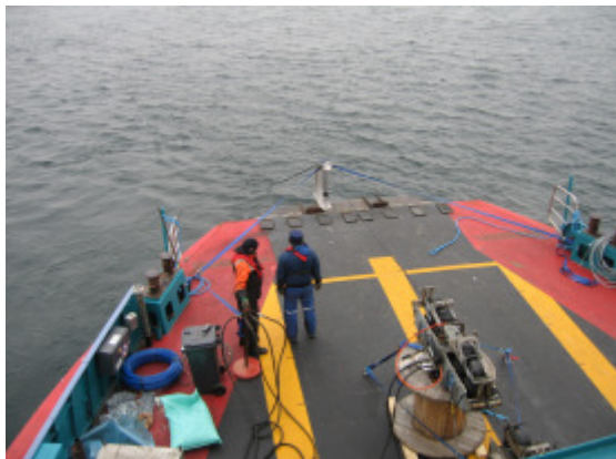
Bild 3: Zum Verlegen des rund 26 Kilometer langen LWL-Kabels von Friedrichshafen nach Konstanz benötigte das Team nur rund zehn Stunden.
