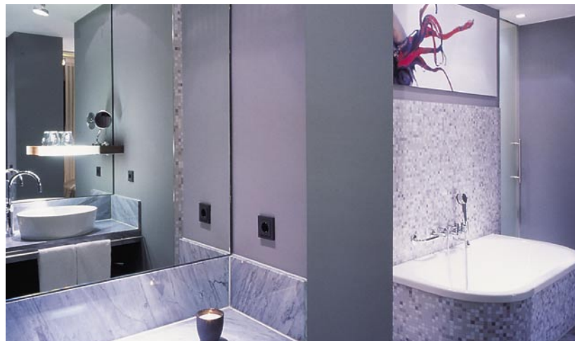
Im Bad wird die Abluft abgesaugt
