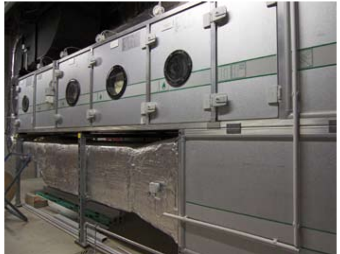
Filter der Klasse F5 bis F9 und eine Aktivkohleeinheit sorgen für saubere Luft in der Leitwarte
