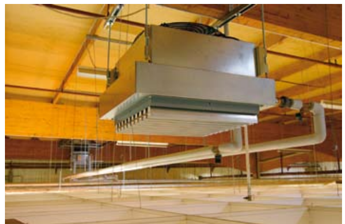
■ Blick unters Hallendach: Die oberhalb der Rasterdecke aufgehängten Lufterhitzer „MultiMAXX“ blasen die Warmluft nach unten aus; hier eines der mittelgroßen Umluftgeräte. Bild: GEA/PNR
