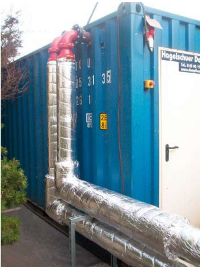
■ Diese mobile Heizzentrale versorgte übergangsweise den Möbelmarkt mit Wärme.
