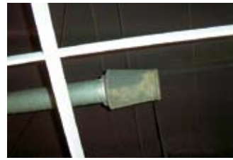
■ Induktionsauslass der alten Heißluftanlage. Bild: Nießing
