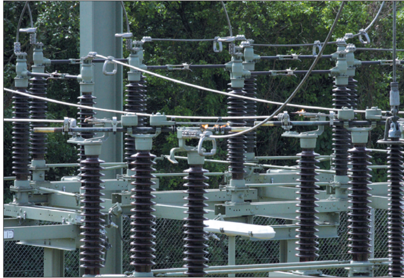
Nach den positiven Tests wird die Fernwirktechnik scharf geschaltet. Das Umspannwerk ist wieder »fernbedienbar«
