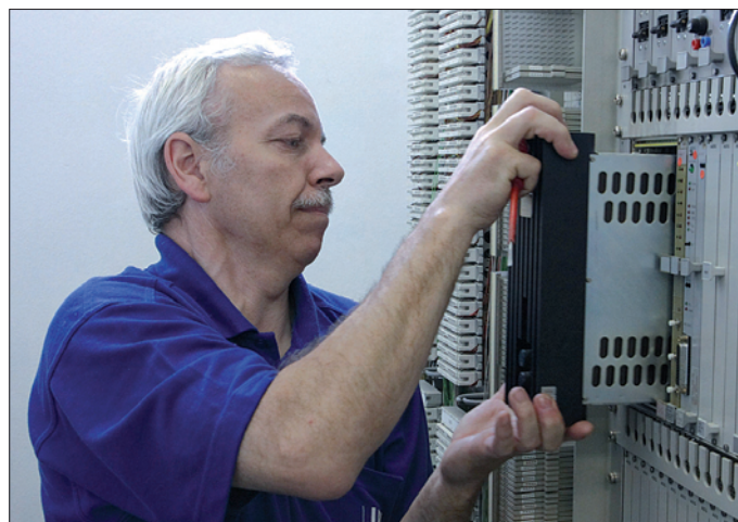
Vor der Demontage der alten Fernwirkgeräte sichert Techniker H. Schuster potenzielle Ersatzteile für andere Altanlagen
