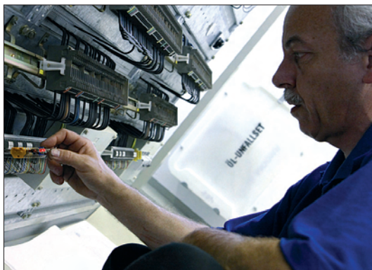
H. Schuster prüft, ob die Fernwirksignale ankommen, sein Kollege M. Klimesch meldet die Ergebnisse telefonisch an die Netzleitstelle
